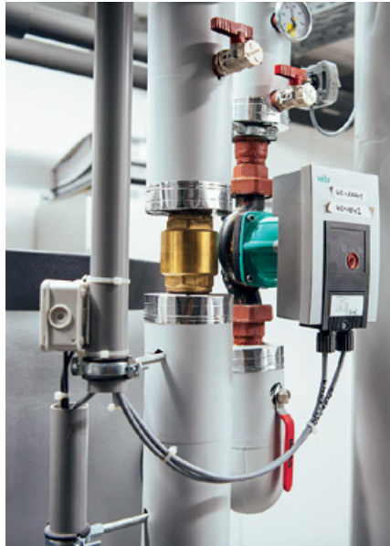
Heizungsanlage Foto: EA Tirol / Dallago
